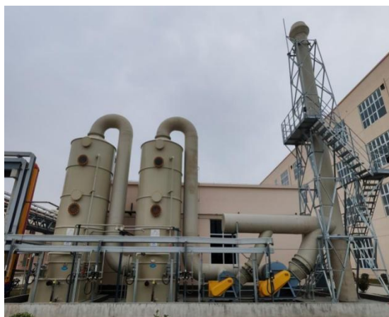
甲类仓库废气处理设施
