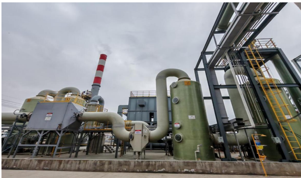
RTO 焚烧装置设施
