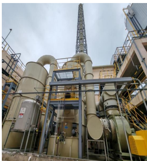
污水站低浓度废气处理设施
