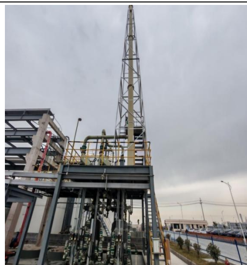
储罐区酸性废气处理设施
