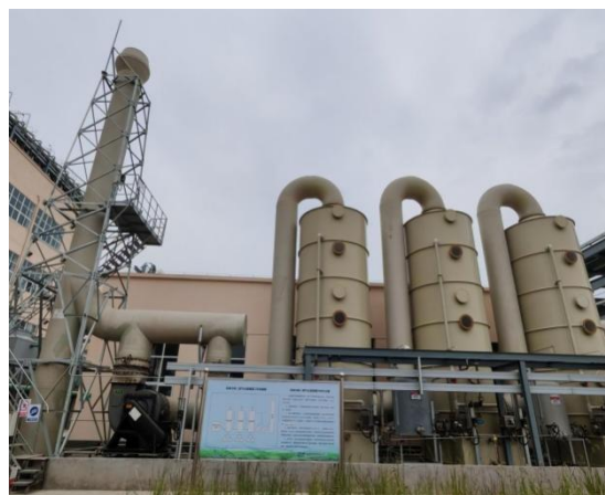
危废仓库废气处理设施
